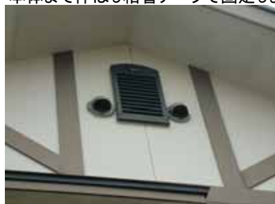
施工完了 パイプフードは必ず標準付属品をご利用ください。市販品では風量の低下やネットの目づまり等不具合が発生する可能性があります。
